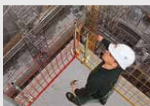
Sistemas de Seguridad
