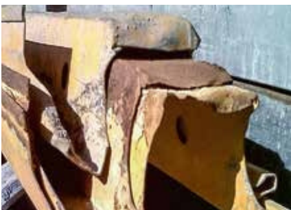
Rodapié de acero UPY ■ Importante deformación en los bordes del rodapié
