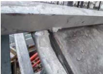
Plataforma de paso UAL ■ Cordón de soldadura defectuosa en el elemento de montaje
