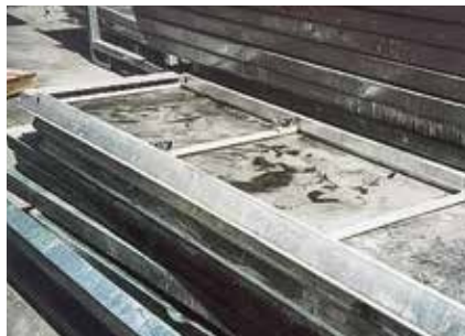
Plataforma de paso UAL ■ Escalera dañada ■ Perforaciones en la plataforma ■ Cierre de presión dañado
