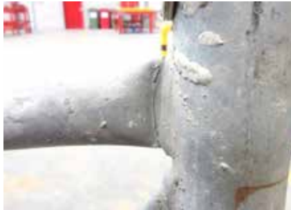
Grieta en la costura de soldadura de PRK o MRK
