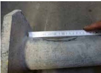
Importante abolladura en MP 50
