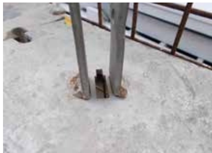
Falta el mecanismo de seguridad o está dañado
