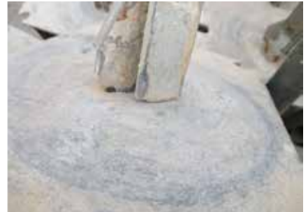
Grieta en el agarre del cabezal
