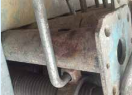
Daño por calor
