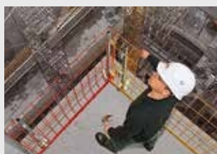
Sistemas de Seguridad
