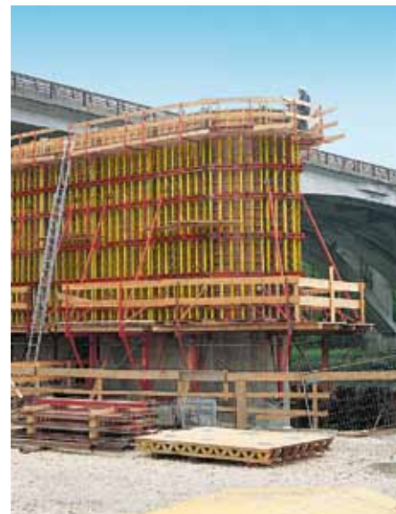
Pilas huecas en las orillas del río, trepadas con VARIO GT 24 sobre consola trepante PERI KG 240. Los frentes arqueados se realizaron con piezas estándar VARIO y módulos superpuestos.
