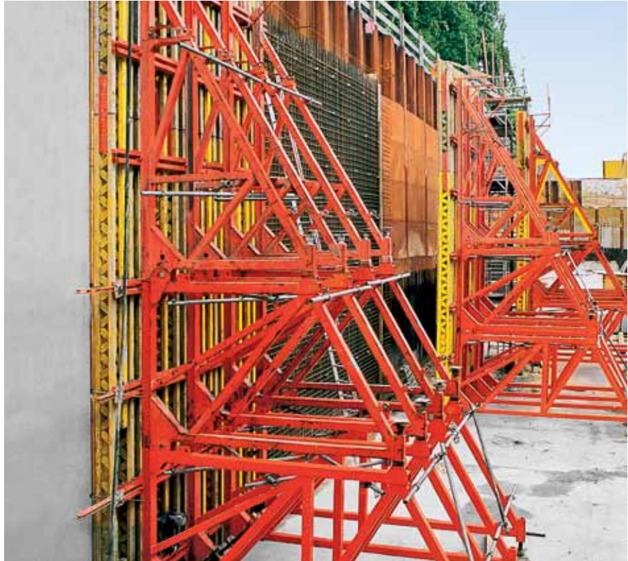
Altura de hormigonado máx. 8,75 m, Escuadra SB-A0, A, B y C con encofrado para muros VARIO GT 24.
