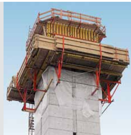
Torre de iglesia en Feldmoching, Múnich. VARIO GT 24 sobre consola trepante KGF 240.
