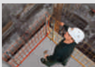
Sistemas de Seguridad
