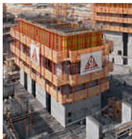
Trabajo seguro con protección lateral y posterior integral, tanto sobre como bajo el encofrado trepante RCS.
