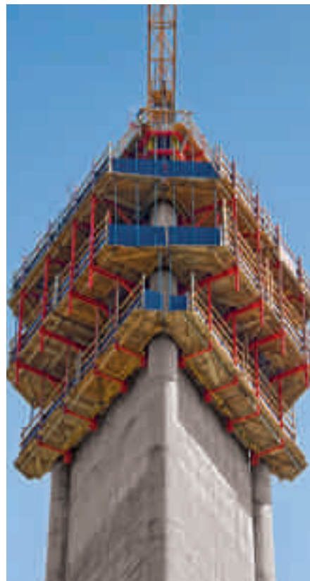
Como alternativa a un cerramiento completo, también se logra protección contra caídas segura con tubos de andamio o tablas de barandilla.
