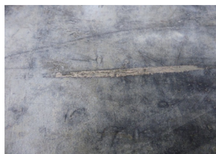
Daños de >1 mm de profundidad
