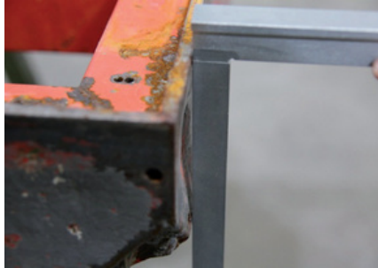
Abolladura en el perfil de > 5 mm de profundidad
