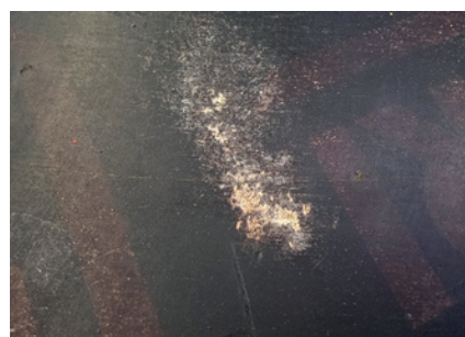
Daños causados por el uso de un vibrador de hormigón
