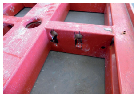
Tubos del perfil I perforado dañado
