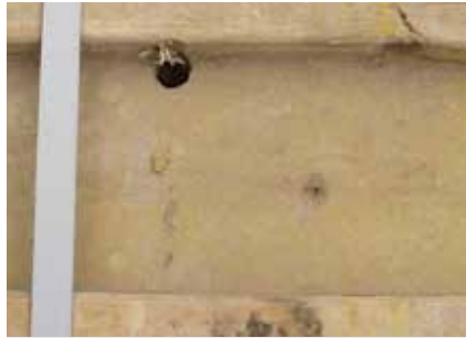
Perforaciones en el alma de la viga que no son necesarios para los componentes del sistema de PERI
