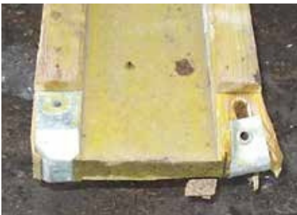
Tapa final dañada con astillado en el bastidor
