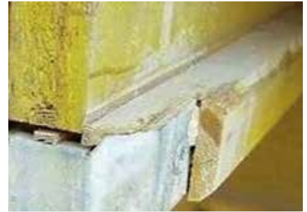
Rotura de la conexión de la ranura entre el alma de la viga y el bastidor
