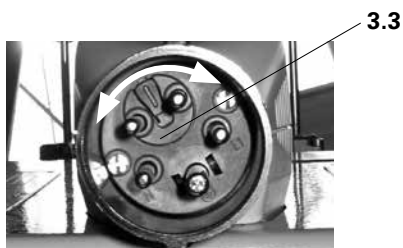
Fig. 39: Toma corriente con inversor de fases
